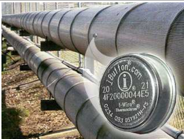
Энергоконтроль и энергоаудит. Мониторинг объектов теплоснабжения
